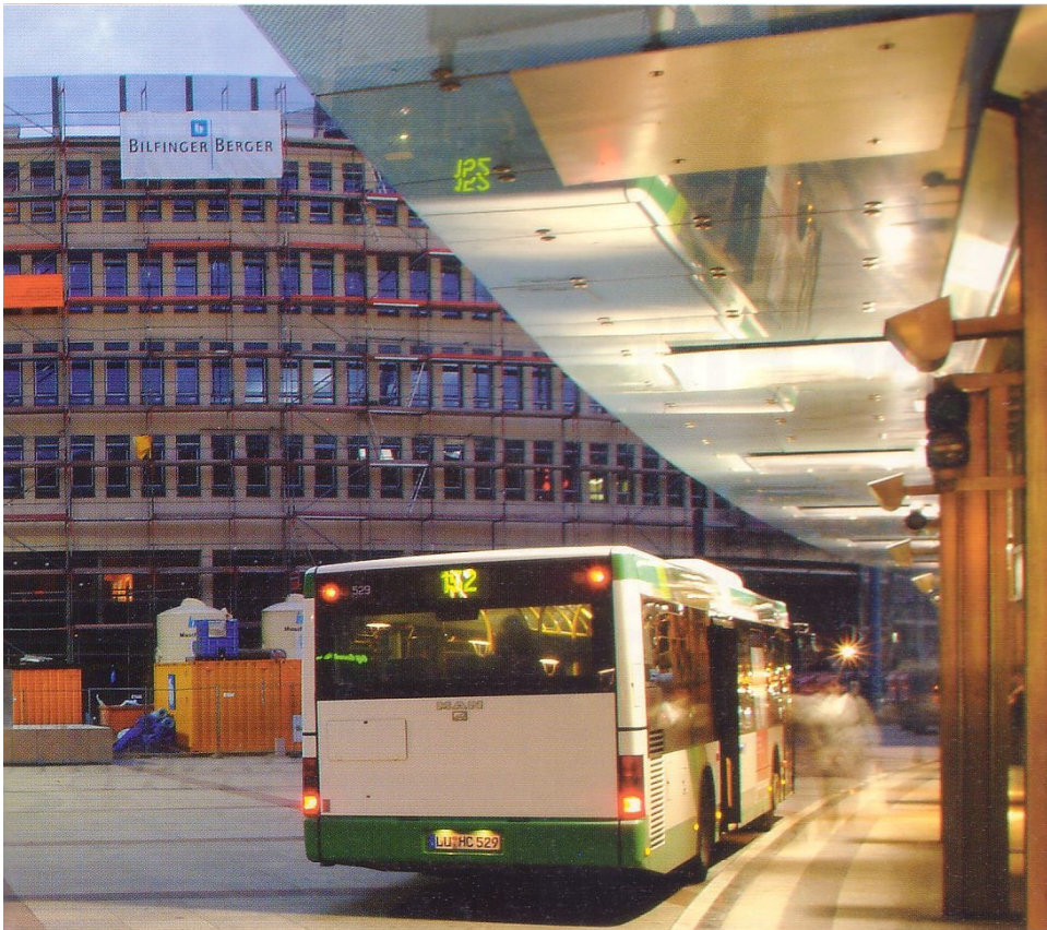
Abendstimmung am Berliner Platz in Ludwigshafen. Noch umgeben Gerüste das mittlerweile fertig gestellte Faktor-Haus.
